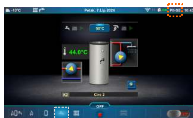
Zaslon potrošne tople vode (PTV) (PII-SE)
