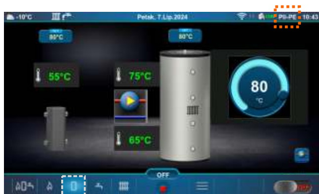
Zaslon akumulacijskog spremnika (PII-PE)
