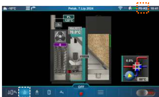
Zaslon kotla (PII-KE)
